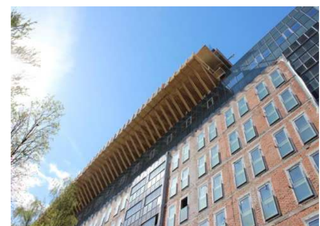
Индивидуальные строительные леса
